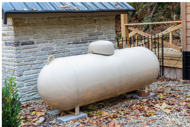
Figura 4. Tanque de propano.
